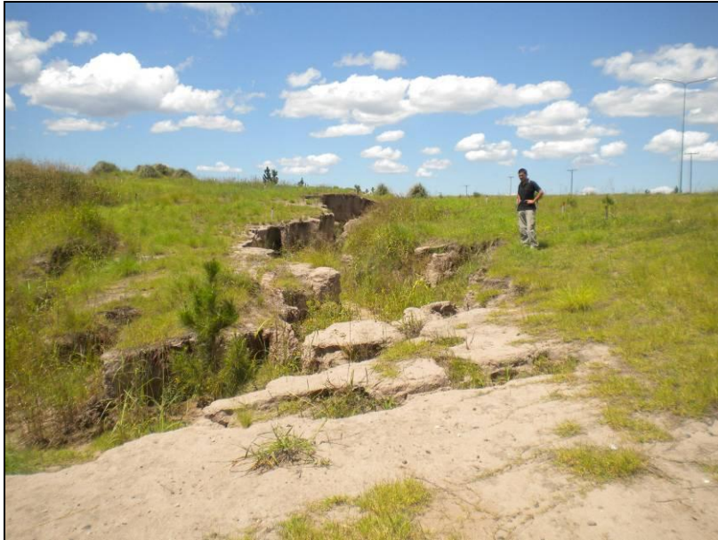
Daño causado por escorrentía en pendiente sobre margen de ruta.
